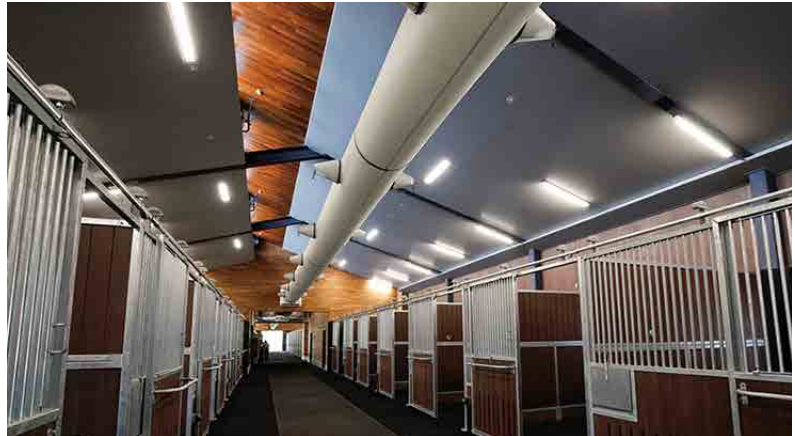
クーラーが稼働すると、冷気が天井付近に設置された白い筒状のものを通り排出される
